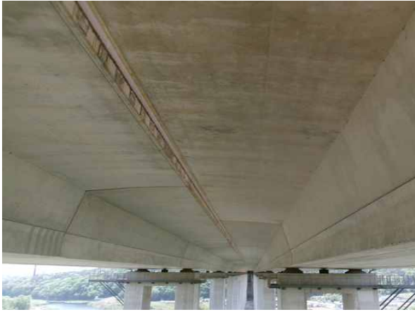
바닥판 종조인트 상태양호
